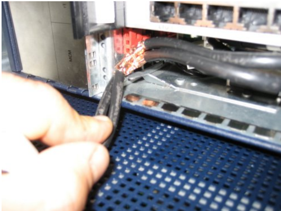
Figura 50: Cabo DC descarnado
