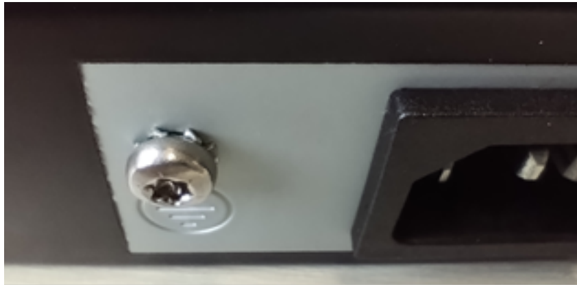
Figura 1: Equipamento de ligação à terra de proteção
