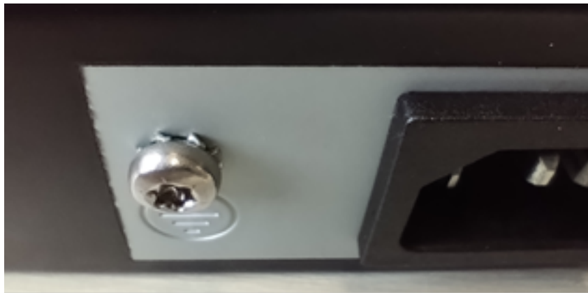
Figura 1: Equipamento de ligação à terra de proteção
